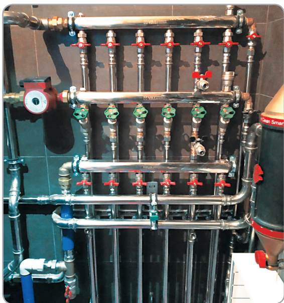
Коллектор системы отопления
