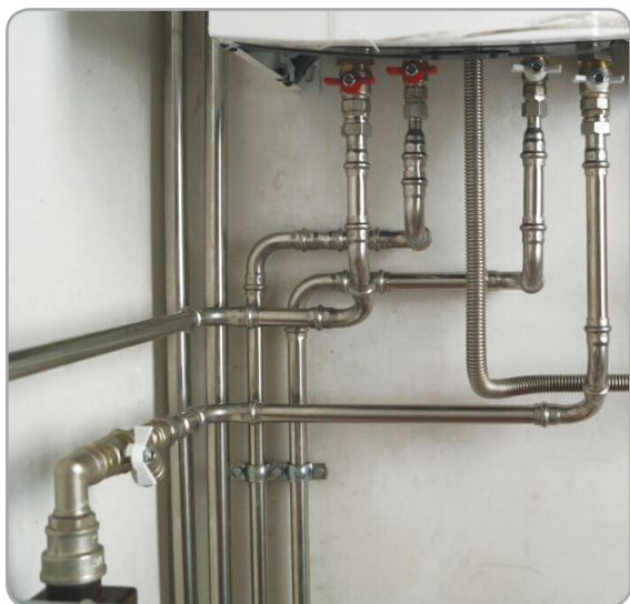
Подключение двухконтурного газового котла
