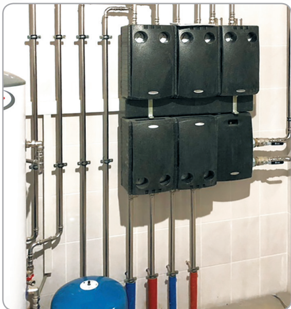
Котельная частного дома
